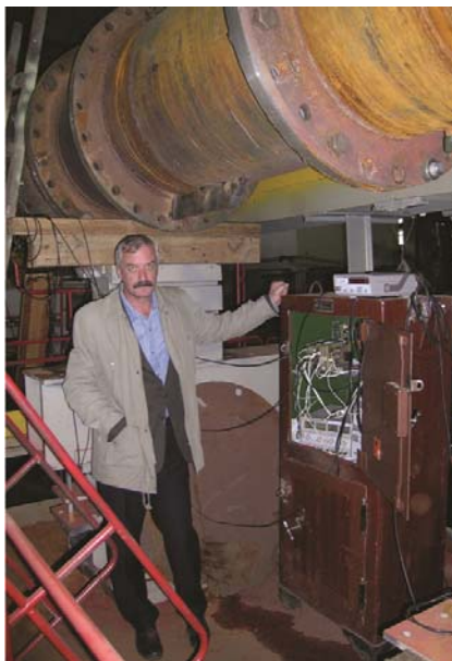
С.Г. Михайлов у трубопровода охлаждения корабельной турбины с аппаратурой активного гашения
